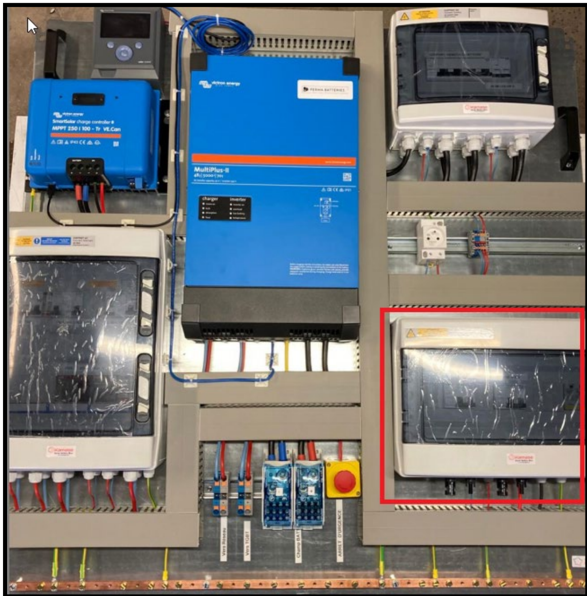
Emplacement du coffret « solaire » sur la platine
