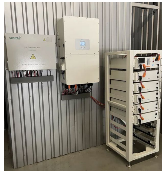
Exemple 2 : 30KVA et 5x modules batteries (25 kWh)
